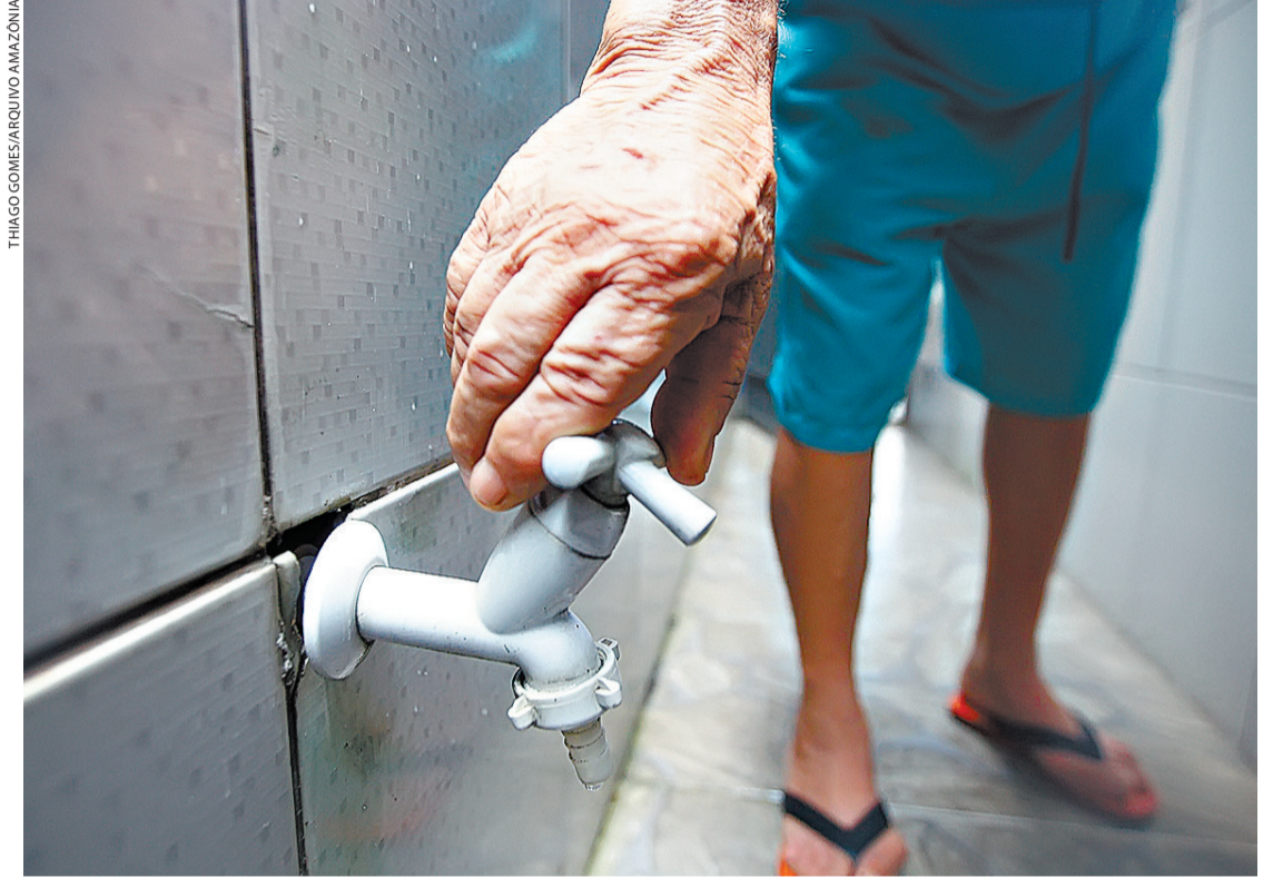
Fornecimento ficará suspenso das 22h de quinta até as 12h do dia seguinte. Cinco bairros serão afetados.
